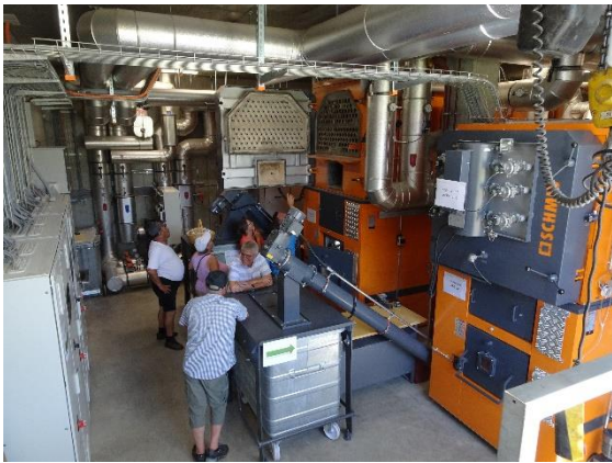
Die Besucher liessen sich die Heizzentrale erklären
