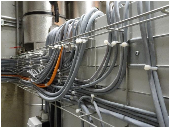
Elektroinstallationen in der Heizzentrale
