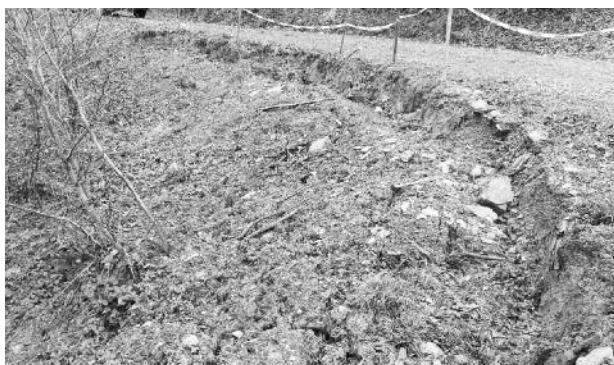
Hangrutschung an der Schwendistrasse
