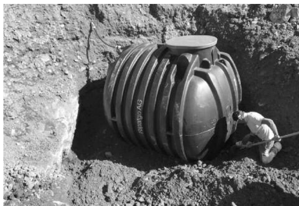
Neuer Quellwassertank mit 10'000 Liter Fassungsvermögen. Eingebaut im Obersäss
