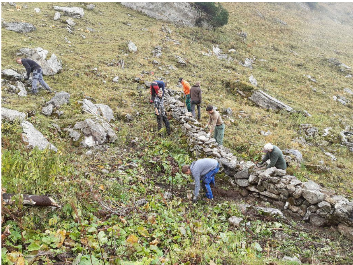
Die Grenzmauer zwischen Alp Tesel und Alp Grueb wird von Freiwilligen saniert.
