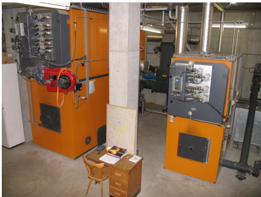
Heizzentrale NWV Hof, erbaut 1996
