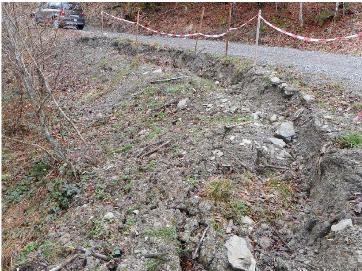
Hangrutschung an der Schwendistrasse
